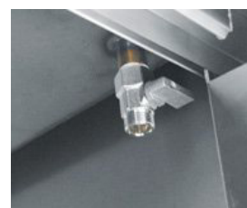
Valvola scarico acqua
