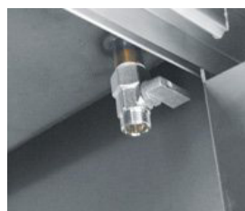
Valvola scarico acqua
